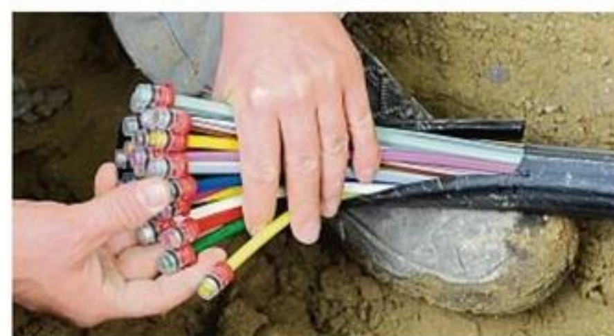
Glasfaserkabel stellen eine schnelle Internet-Verbindung sicher.
