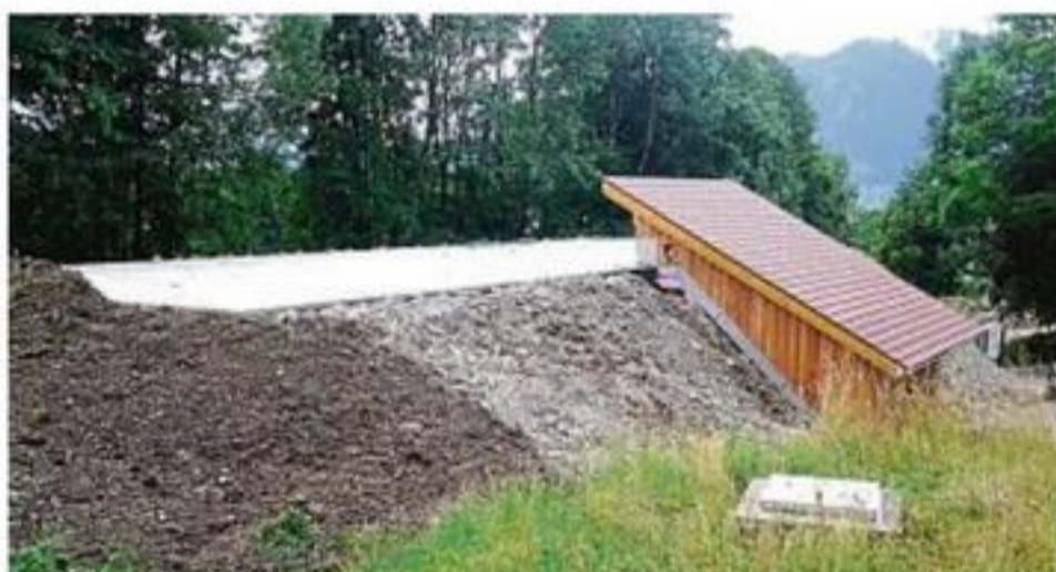
Fast nicht mehr zu sehen: Der neue Trinkwasser-Hochbehälter ist bereits zum Großteil mit Erdreich abgedeckt.
