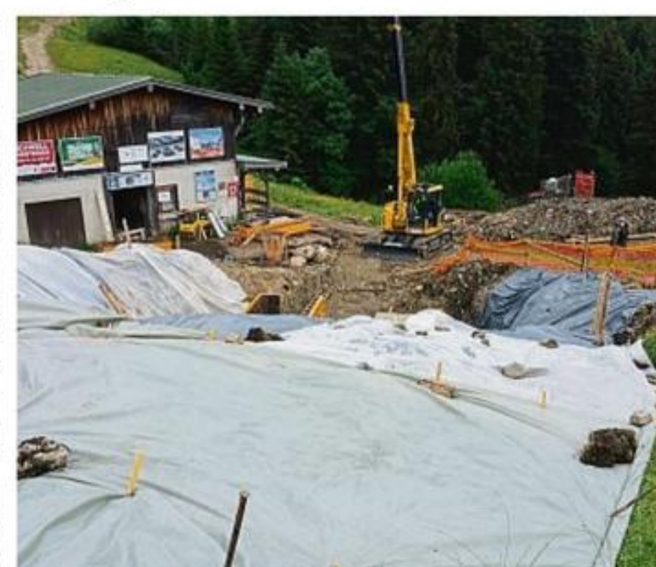
Baustelle am Berg: Hier entsteht derzeit das Pumpwerk Fins-termünz bei der Florilift-Talstation.
